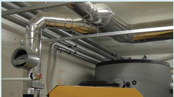
Details der Anlage mit diversen Sonderteilen
